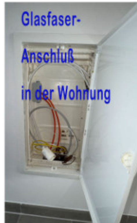
Elektro- Verteiler übersichtlich
